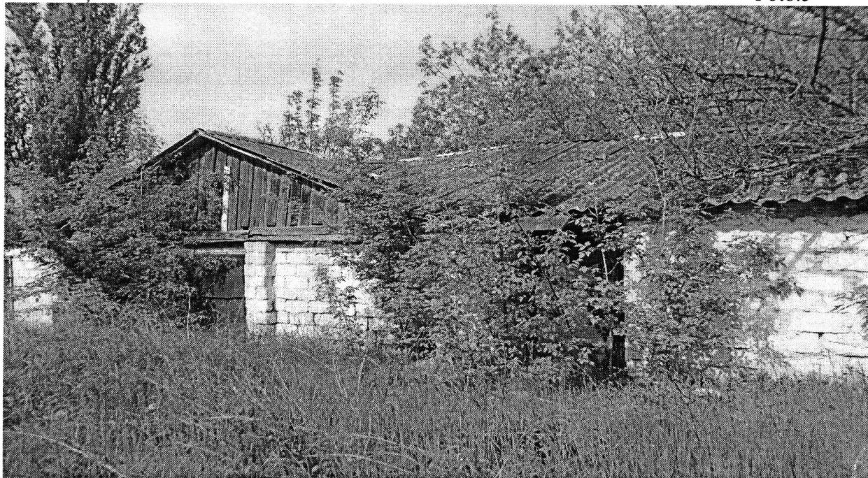
Construcție cu un nivel cu fundația din piatră, pereții din calcar, acoperișul din ardezie, fără rețele ingineresti. Starea tehnică satisfăcătoare
